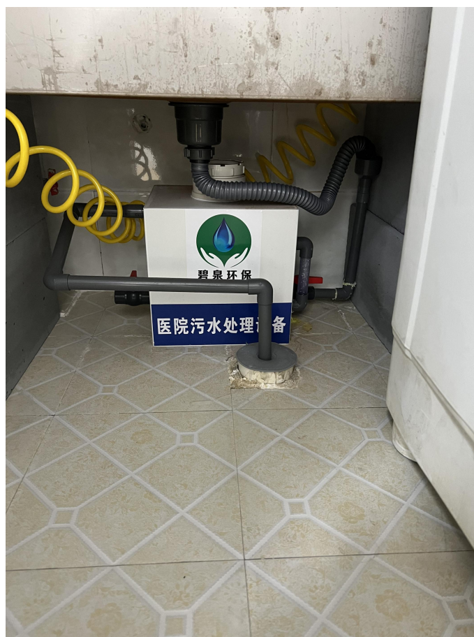
图 4-1 医疗废水处理设施照片
