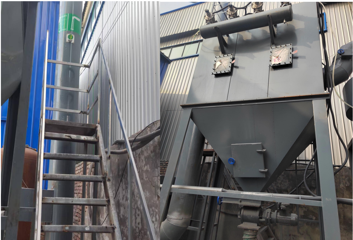
图 3 DA001 喷锌废气排气筒出口
