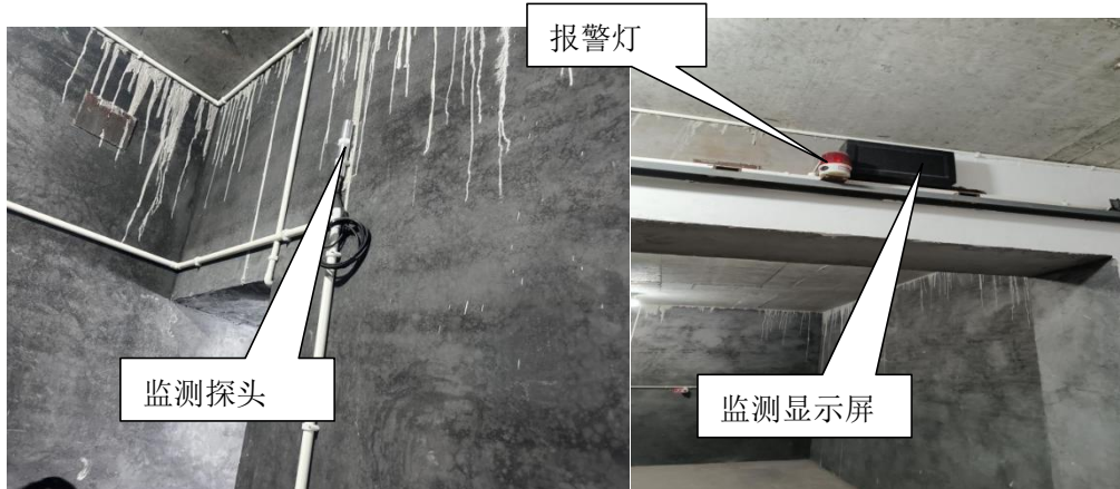
图 8-15 探伤室内固定式监测探头
